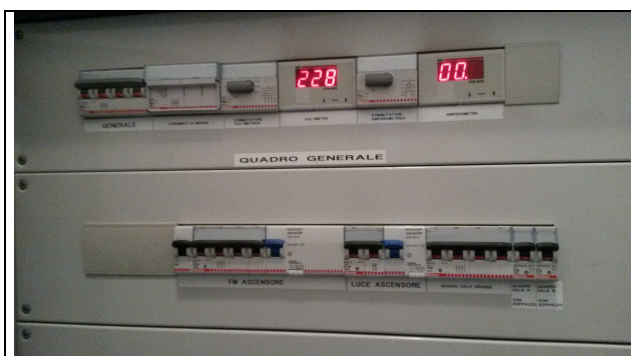
Interruttore differenziale generale (in alto a sx)
