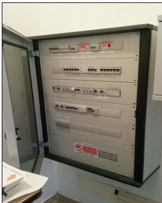
Quadro Elettrico Generale sala piano terra
