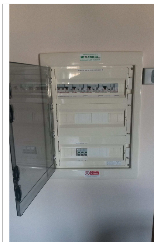
Quadro elettrico sala piccola
