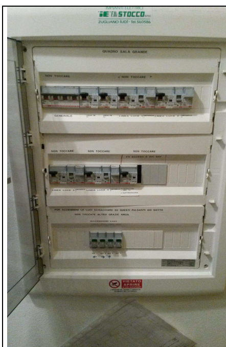
Quadro elettrico sala grande
